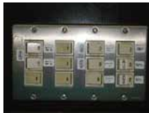
フロント周辺照明
